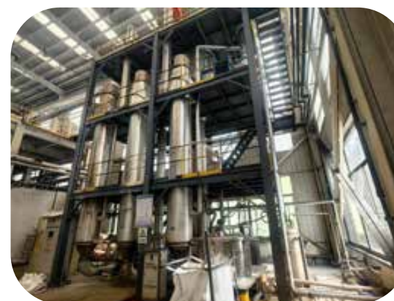
三效蒸发设施
